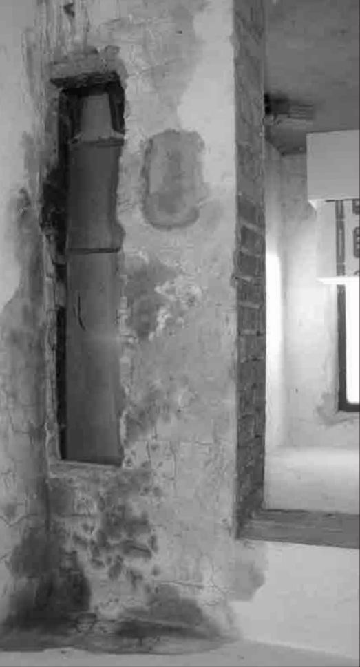
Ściana po pożarze w kominie
